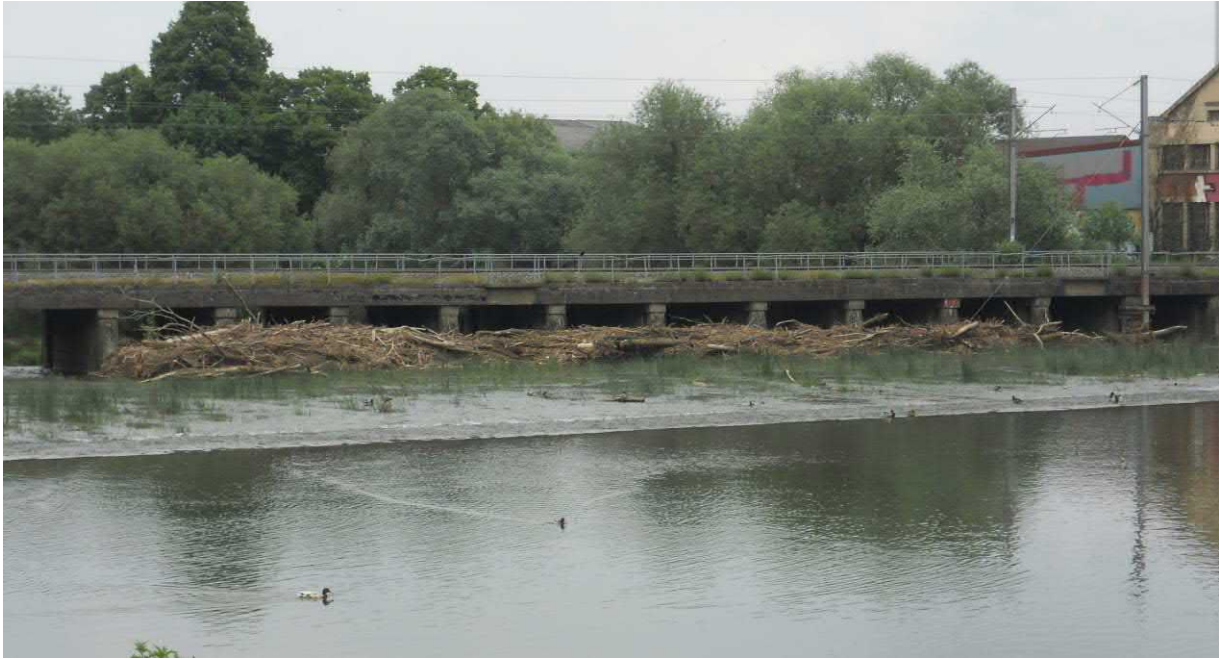
Autre ouvrage sensible en cas de crue : le pont du chemin de fer dit « pont 1000 pattes » à Mulhouse présente un risque important d’embâcle (Photo CD68, 2015)
