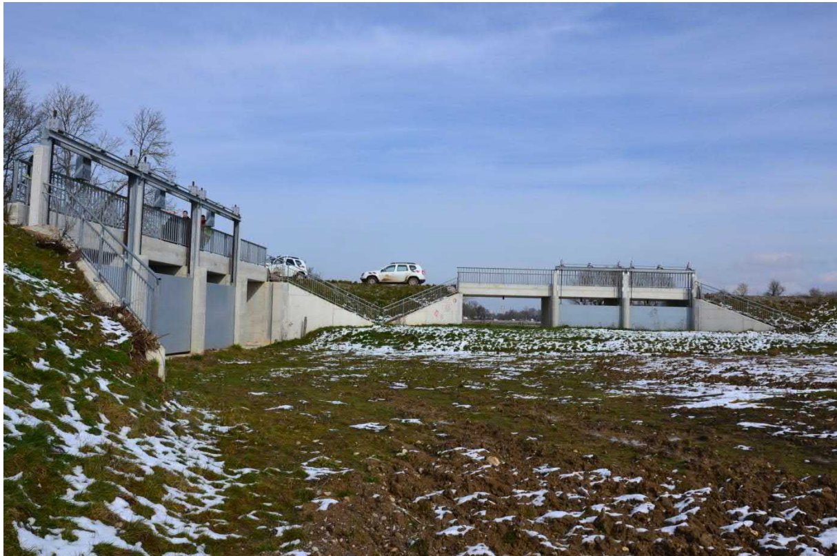
Importants travaux de protection contre les inondations à Brunstatt-Didenheim (2014-2018) : la zone de ralentissement dynamique des crues de l'III (ZRDC - casiers), dont la capacité totale sera de 350 000 m 3 , sont co-financés par le Syndicat Mixte de l'III et le Conseil Départemental (Photo CD68)
