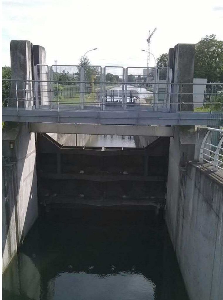
La porte aval levante de l'écluse 41 à Mulhouse permet d'assurer l'écrêtement des crues de l'Ill par le Canal du Rhône au Rhin pour un débit maximum de 30 m 3 /s (Photo L. With, 2017)
