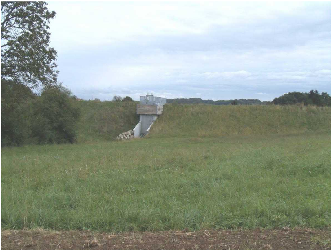
Zone de ralentissement dynamique des coulées d'eau boueuse (ZRDC) à Obermorschwiller en 2012
