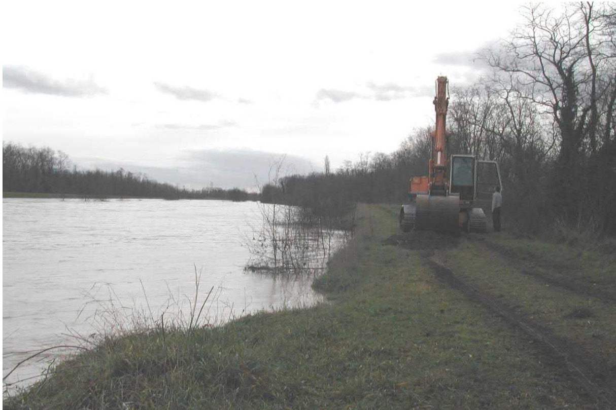
Surveillance d'une digue en crue (intervention) à Sainte-Croix-en-Plaine - janvier 2004 (Photo CD68)
